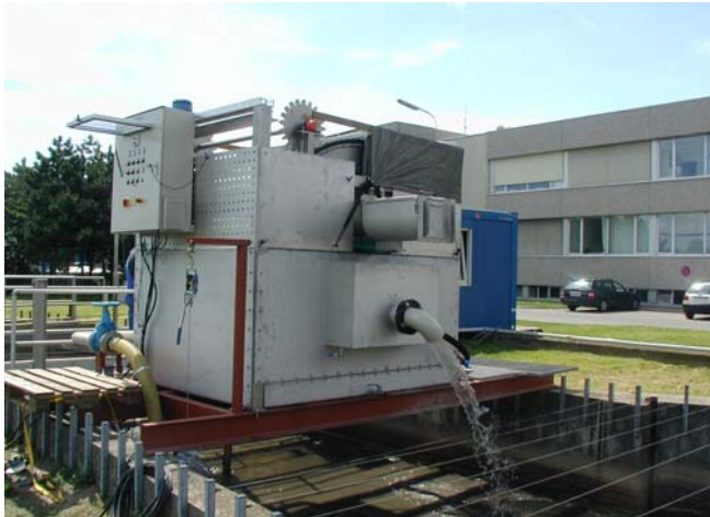
Abbildung 6: Feinsiebung auf der Hauptkläranlage Wien
