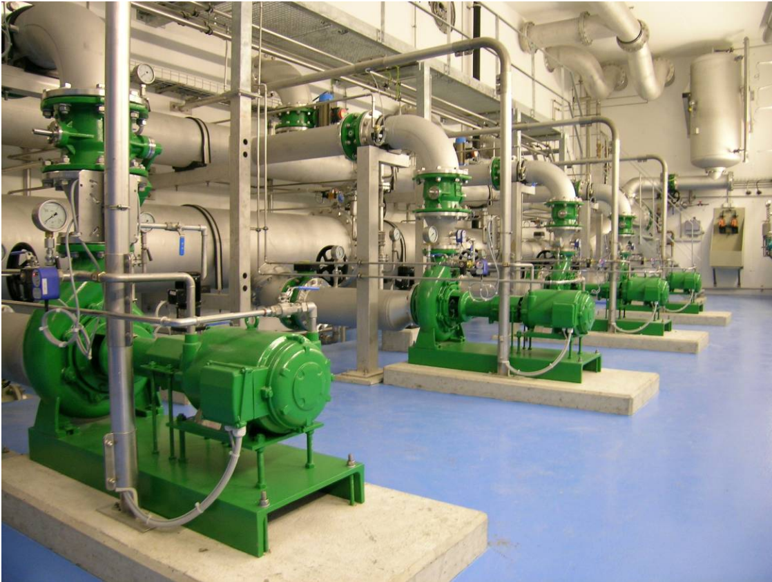
Abb. 2: Rohwasserpumpwerk – ein Energieaspekt – im neuen Seewasserwerk Männedorf
