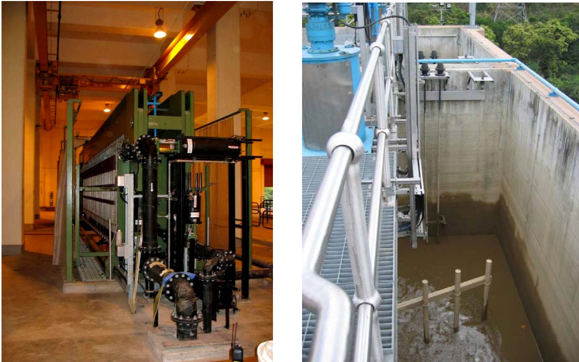
Abb. 1: Kammerfilterpresse und Schwemmwasserauffangbecken – WTP Tai Po, Hong Kong
