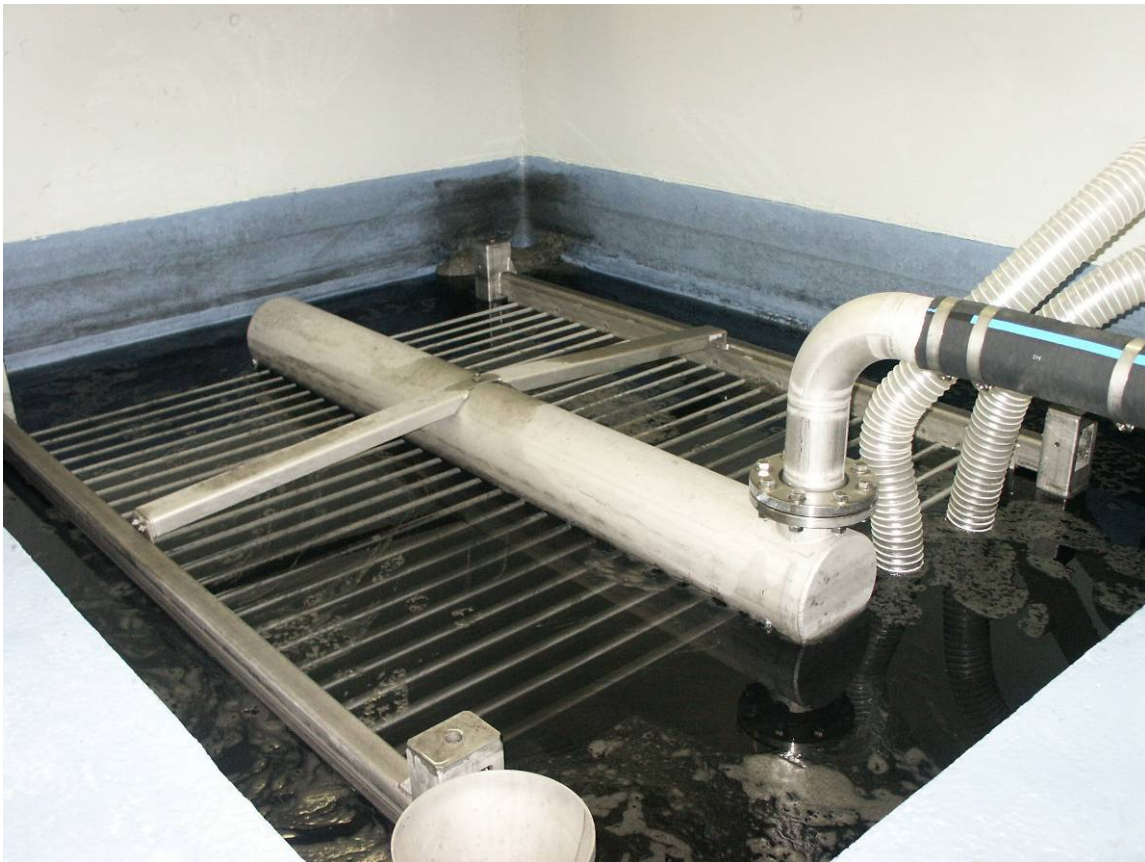
Abb. 3: Ultrafiltrationsbetrieb der getauchten Membran, SWW Männedorf
